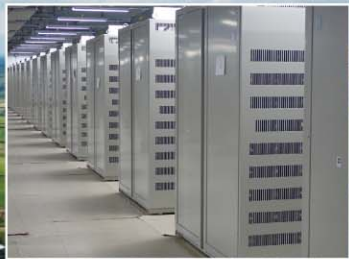
建物に格納された蓄電池。
