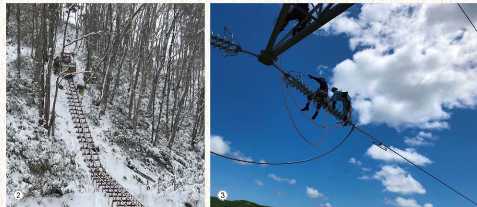
①稚内から中川町へ、約78kmに及ぶ送電線の地線緊線作業。鉄塔に登ると半日は下りずに作業をすることもあるという。②道など全くない山中に鉄塔を建設する際は、モノレールを敷設して資機材を運搬することもある。作業終了後は撤去する。③送電線のがいしを検査する。冬場、着雪すると、人が登って手作業で雪を払うこともある。以上、写真提供=北海道北部風力送電
